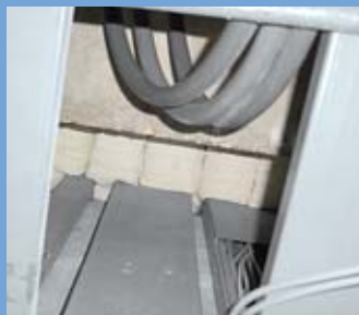
Barriera antifiamma con cuscini di amianto
