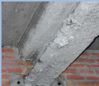
Isolamento in amianto spruzzato
