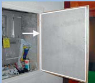
Pannello antincendio contenente amianto
